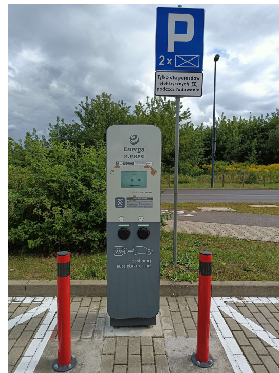
Rys. 3.6 Stacja ładowania pojazdów elektrycznych w Olsztynie
